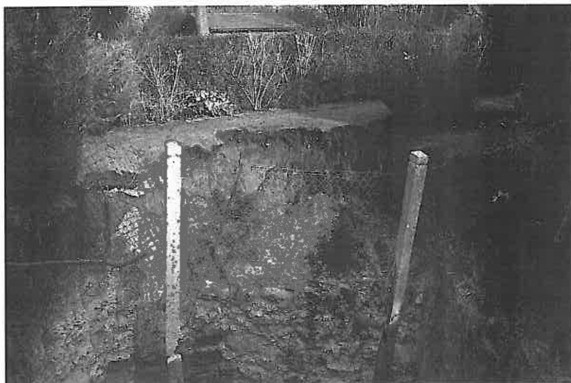
Effondrement de cavité à Fâches-Thumesnil
